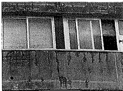
Figura 1 - Corrosione promossa da carbonatazione in classe di esposizione XC4
