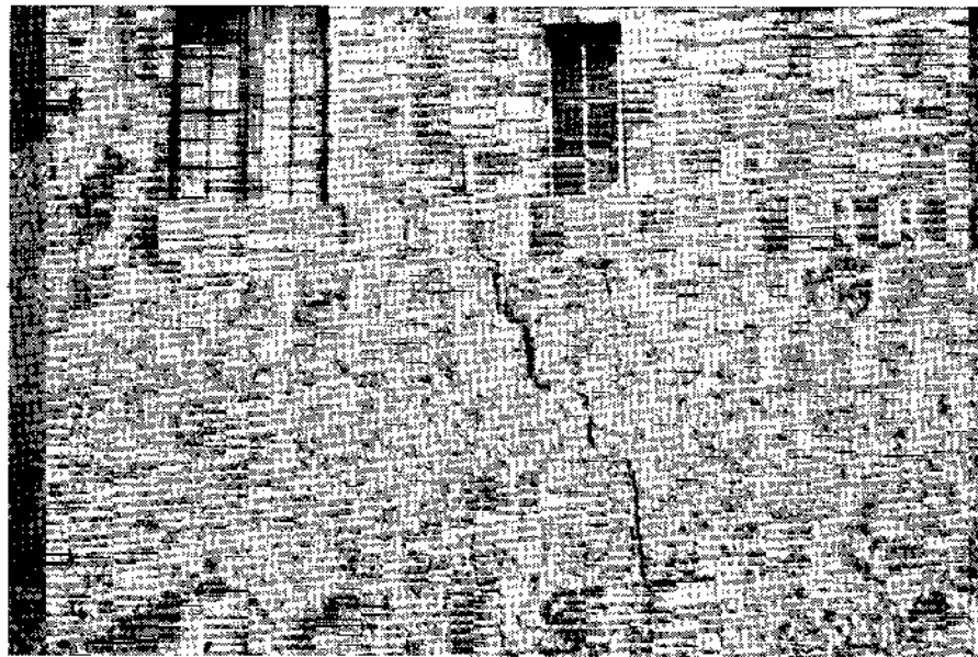
Fig. 9 - Abbazia del XII secolo a Orvieto: degrado della muratura in pietra.
